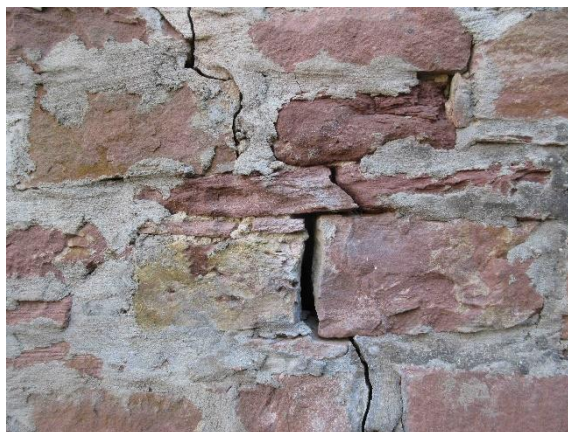
Foto 2: Scheune, Spalte auf der Nordseite
